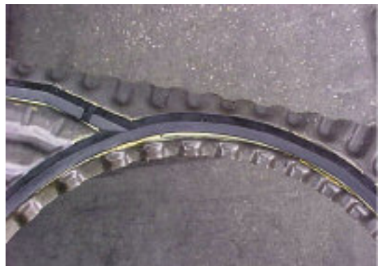
Packningen vid en öppning har limmats snett i spåret.
